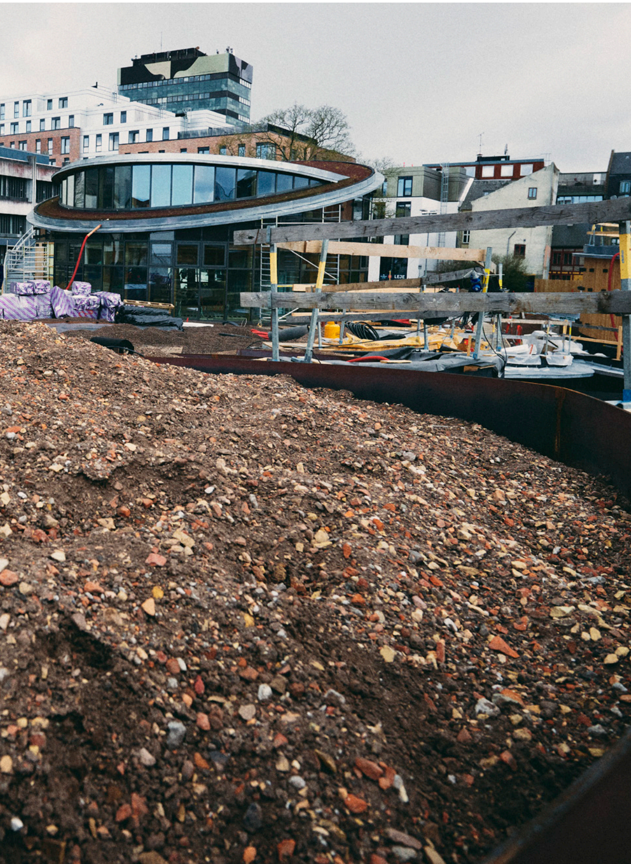
Det nye H.C. Andersens Hus under opbygning. Det forventes at være færdigt i sommeren 2021.
